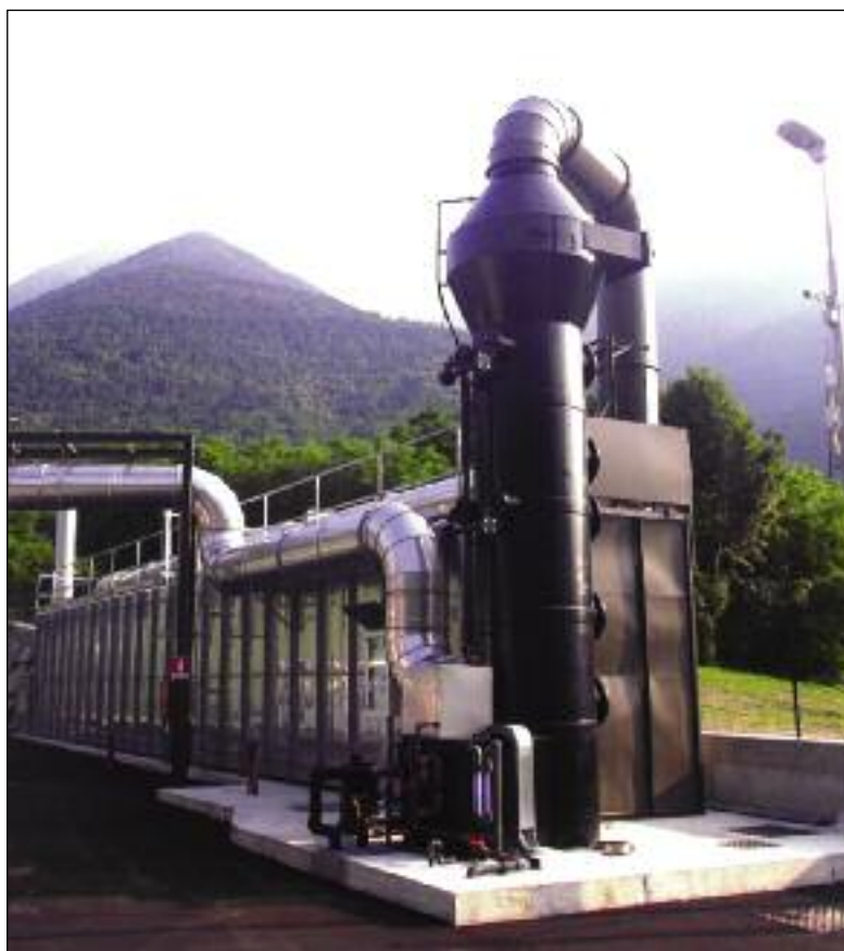
Impianto di biofiltrazione
